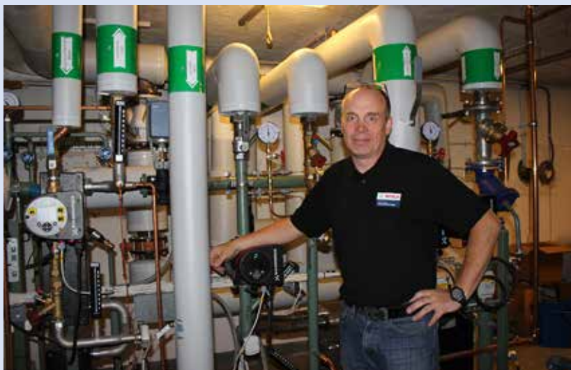
Johan Persson på Sandbäckens Rör inspekterar undercentralen i anslutning till Hallbos kontor på Västra Storgatan.
